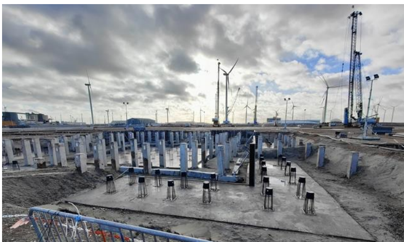
Bron: TKH, de contouren van de nieuwe fabriek voor onderzeese kabels voor de offshore-windindustrie in de Groningse Eemshaven worden langzamerhand zichtbaar. De fabriek is naar verwachting operationeel in Q2 2024.
